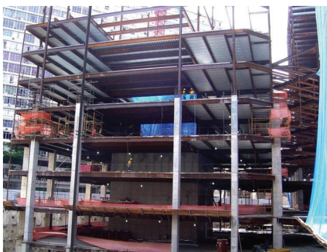
Figura 33: Vista de fachada com os pilares mistos em processo de concretagem (Foto: Ricardo Werneck)
